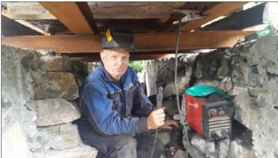
Hans "Hansemann" Vikøyr sørget for å sveise fast tverrgående bjelker under vogna
