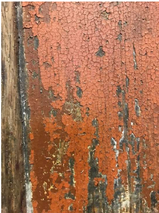
Figur 20. Speil i utvendig sidevegg fra Lyssand-vognen etter at dette er forsiktig vasket med en fuktig klut. Vi ser her rødbrun farge og en mørk brun farge.
