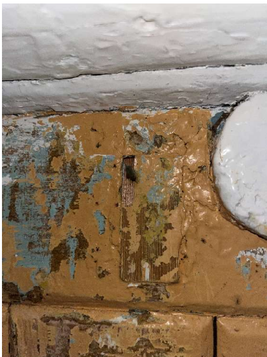
Figur 53. Tappen som står igjen etter skilleveggen innfesting i sideveggen fra perioden 1919 – 1929.
