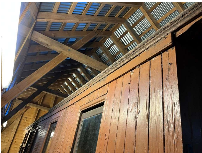
Figur 16. Det langsgående bordet som ble påsatt i 1993 og som har beskyttet øverste del av stående panelbord mot maling.
