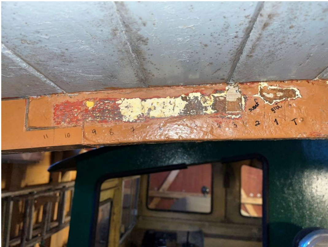
Figur 14. Fargetrapp på bjelken under taket over enden av plattformen på CDFo I. Den svarte fargen er her ikke synlig, men viser på foto, fig. 15.
