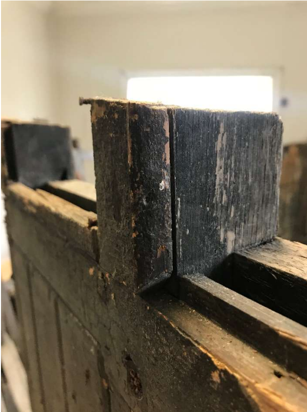
Figur 58. Rester av stående rund list mot stender over vindusparti i Lyssand-vognen. Legg merke til at listen er skråskåret, og at det må ha ligget en tilsvarende list i det horisontale sporet. Legg også merke til at det mellom listen og stenderen er plass til netting. Foto: Per Ivar Tautra.
