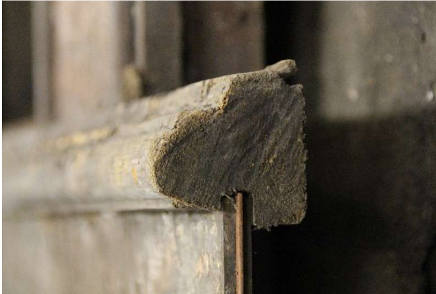
Figur 14. Snitt av profillist i yttervegg på Lyssand-vognen. Legg merke til fjær av jern i det stående panelbordet. Foto: Per Ivar Tautra.
