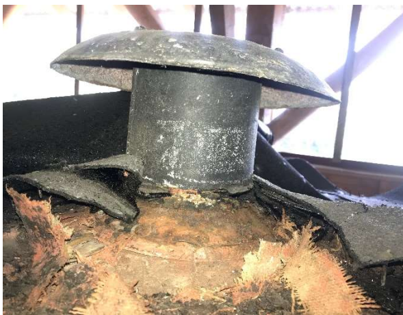
Figur 51 - over: Hetten som står på taket over ventilen på CDFo I i dag.
