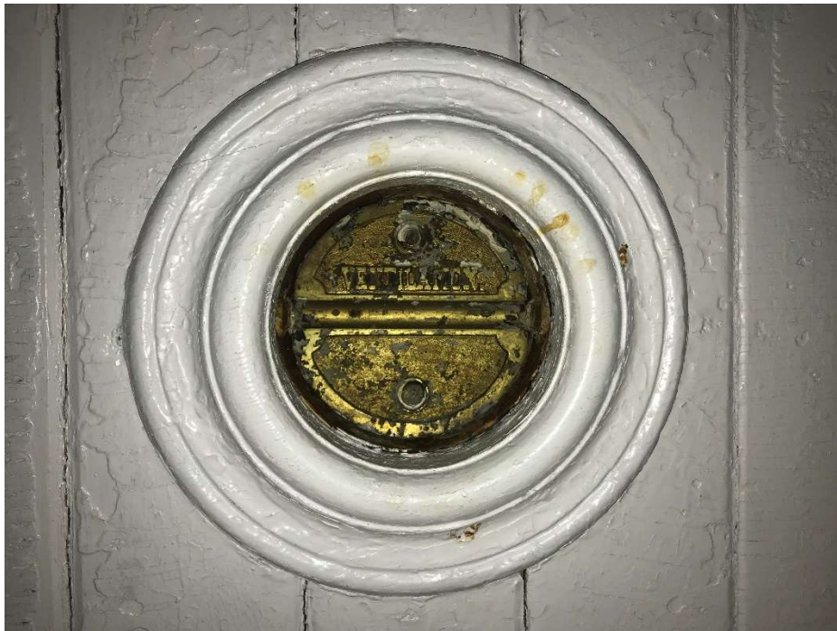
Figur 50. Torpedoventil i taket i CDFo I, her i lukket posisjon sett fra undersiden i kupeen. Profillisten er tilsynelatende unødvendig bred, men den skjuler at biter av takbord er skjøtet inn for å gjøre åpningen mindre enn den opprinnelig har vært.
