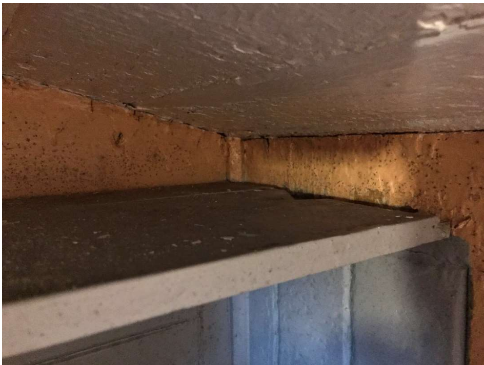
Figur 36. Topp av posthyllen. Lengst ute til høyre, mot veggen, er det en utsparing som gav plass til den flate enden av jernbuen i taket da posthyllen før ombygging i 1929 stod under buen. Midt på hyllen sees en større utsparing for selve buen. Foto: Per Ivar Tautra.
