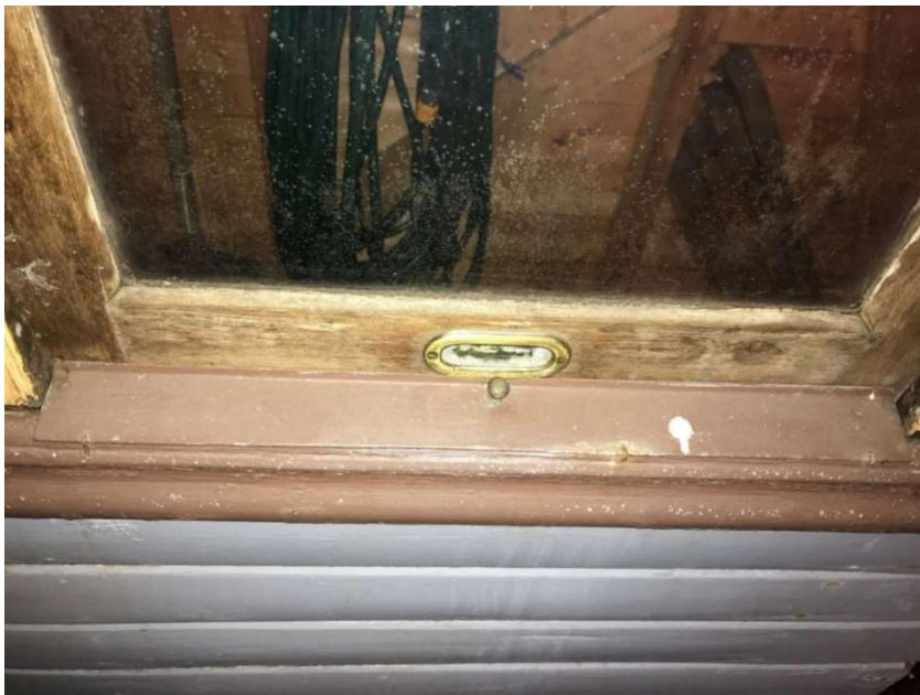
Figur 24. Metallplate over åpning mellom lukket vindu og innvendig vegg. Foto: Per Ivar Tautra.
