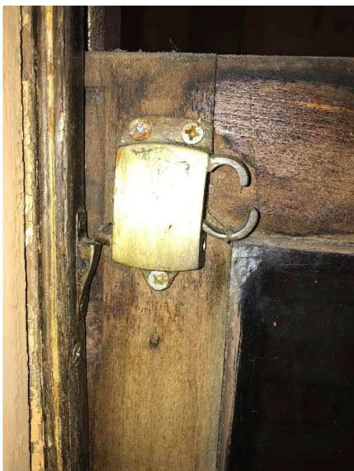
Figur 22. Låsemekanismen på vindusrammen. På listen til venstre sees en av klossene som vinduet skal stoppe mot.
